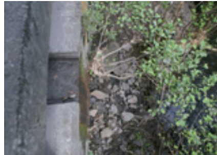
Figura 3. Descargas de drenaje ácido a un río.
