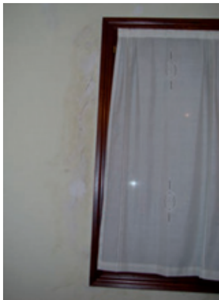
Figura 9. Efectos del drenaje ácido sobre la tabiquería.
