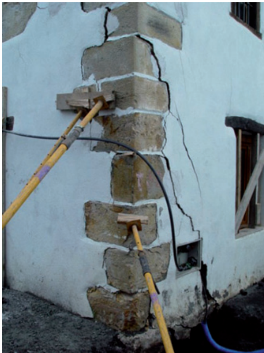
Figura 8. Efectos del drenaje ácido en edificación.
