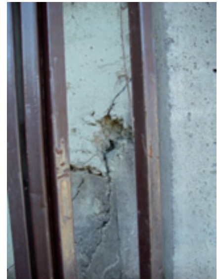
Figura 4. Ataque al hormigón en un muro de contención.
